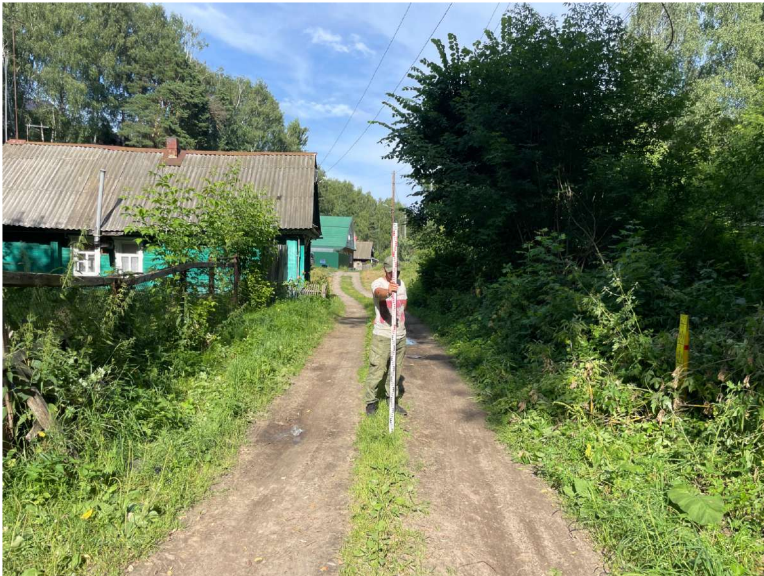
Илл. 9. Нижегородская область, Городецкий р-н, г. Городец, сеть газораспределения к жилым домам по ул. Коммунаров, д. 57 - 2026 г. Вид на 3 часть участка. Точка фотофиксации 1. Фото с 3.
